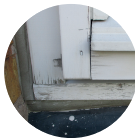
Fuge om vindue
