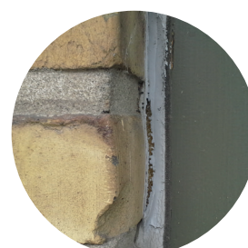
Fuge om vindue
