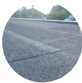
Nyere tagpap lagt på asbestholdig pap
